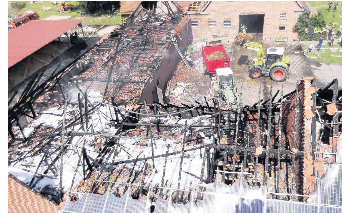
Vom Dachstuhl der Stallungen auf dem Hof in Welte ist nach dem Großbrand wenig übrig geblieben. Mithilfe des THW versuchten die Einsatzkräfte, die noch lebenden Schweine aus dem Stall zu holen.
