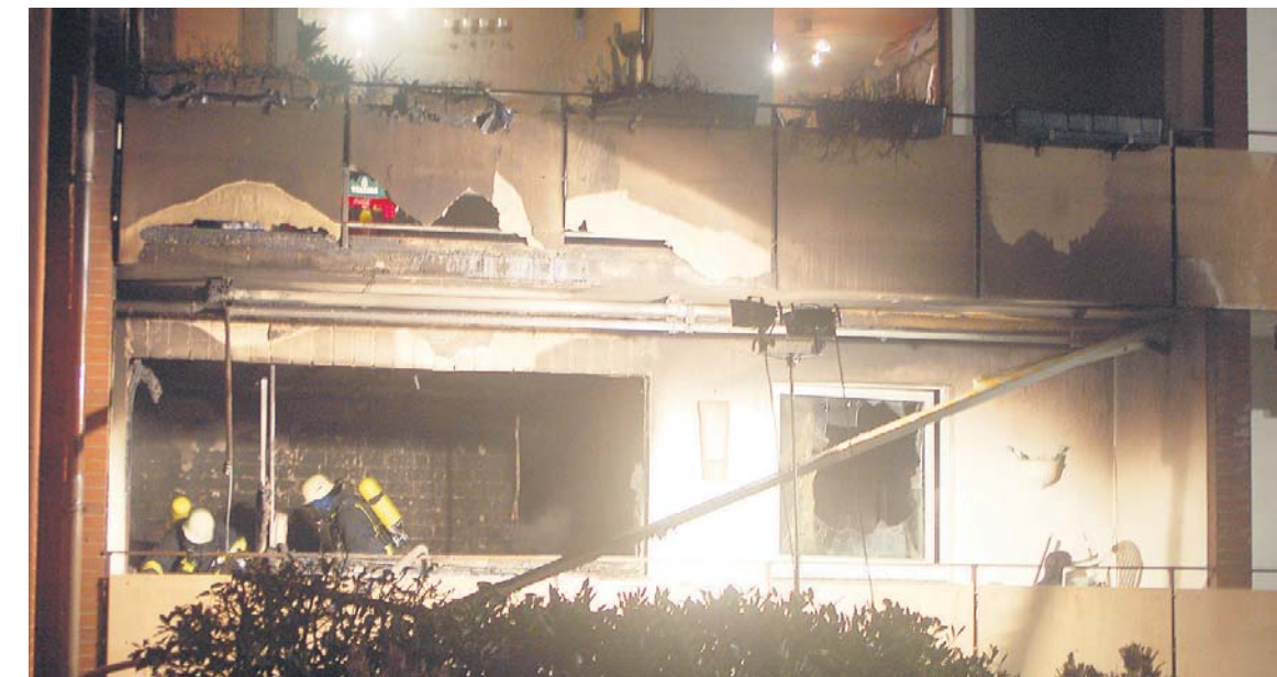
In der Erdgeschosswohnung des mehrstöckigen Gebäudes an der Bahnhofstraße brach das Feuer aus. Die Feuerwehr konnte verhindern, dass die Flammen auf das erste Obergeschoss übergriffen.
