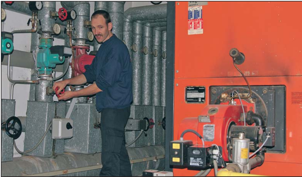
Das Feuerwehrgerätehaus an der August-Schlüter-Straße soll eine Holzpellet-Heizung bekommen. Für die neue Anlage einschließlich der Warmwasseraufbereitung sieht der Etatentwurf 138.000 Euro (davon 44.000 Euro gefördert) vor. DZ-Foto: Daniel Niehues
