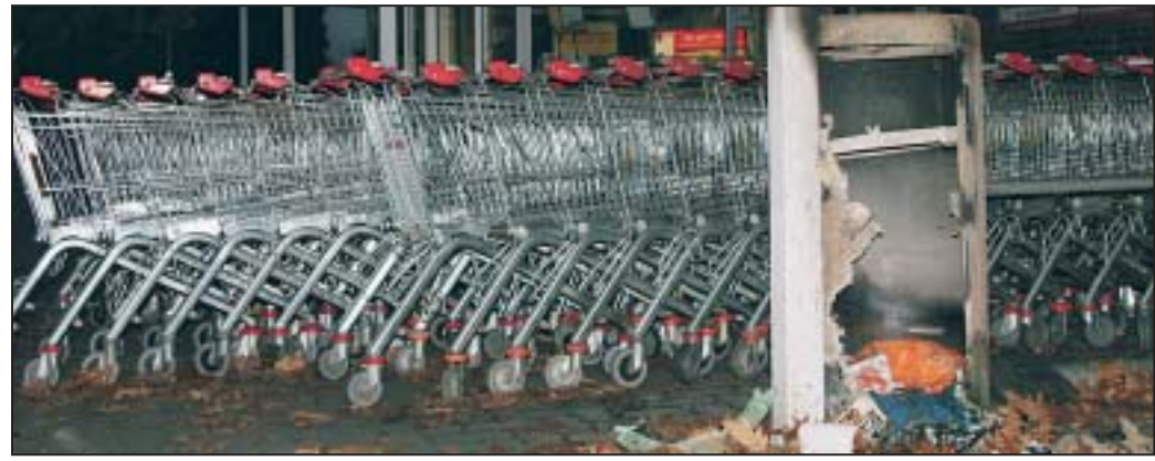
Der Mülltonnenbrand vor dem Extra-Markt hätte weitaus schlimmer ausgehen können. Die Sprinkleranlage löschte jedoch rechtzeitig das Feuer. DZ-Foto: Daniel Niehues
